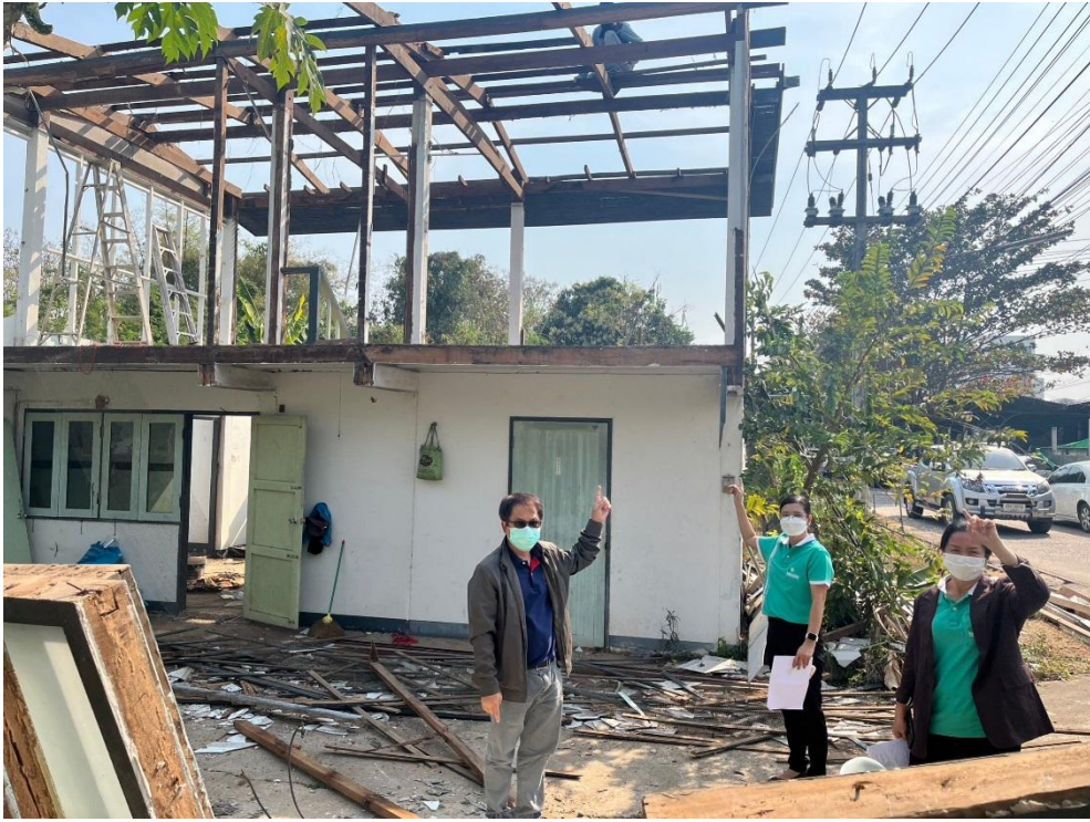
รูปภาพรื้อถอนบ้านพักเจ้าหน้าที่ระดับ ๓-๔ (หลังลำดับที่๓๔)
